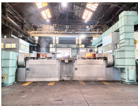
(更新 高周波誘導炉)
